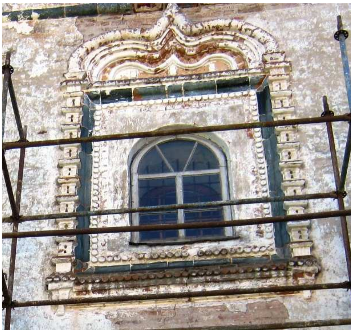
Рис. 2.35. Изразцы в структуре наличника оконного проема Троицкого собора Зеленецкого монастыря. Фото 2011 г.
