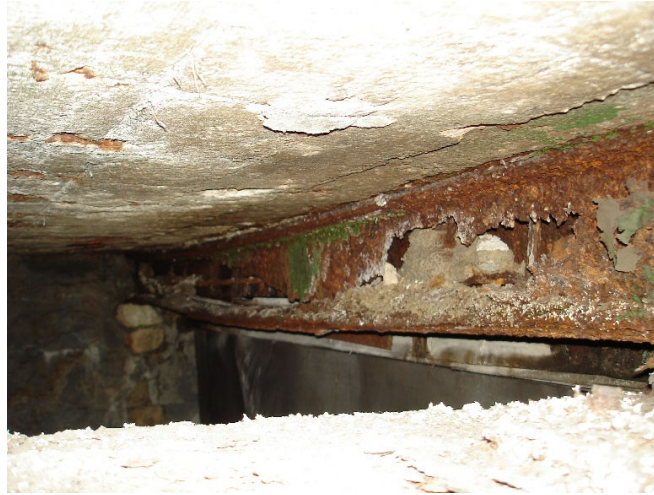
Рисунок 1.1 Коррозия металла общего характера
