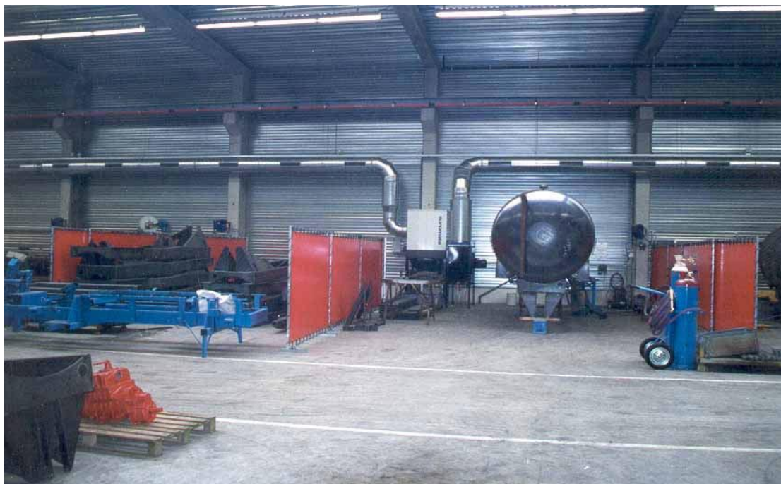
Рисунок 1.11 – Элемент системы Push-Pull в цехе при отсутствии местной вентиляции
