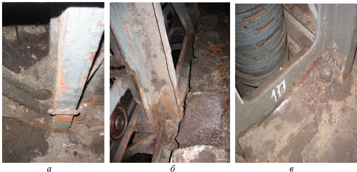
Рисунок 1.8 – Коррозионные повреждения: а – узел соединения горизонтальной и наклонной зон в зоне А снизу; б – нижняя часть металлоконструкции в зоне Б; в – опорный элемент и болтовое соединение в зоне А
