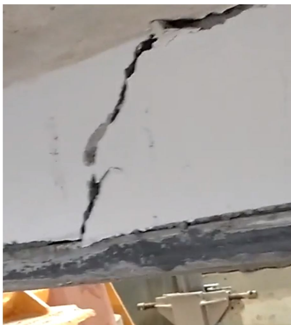
Рисунок 3.14 – Вид разрушения балки III-II по наклонному сечению
