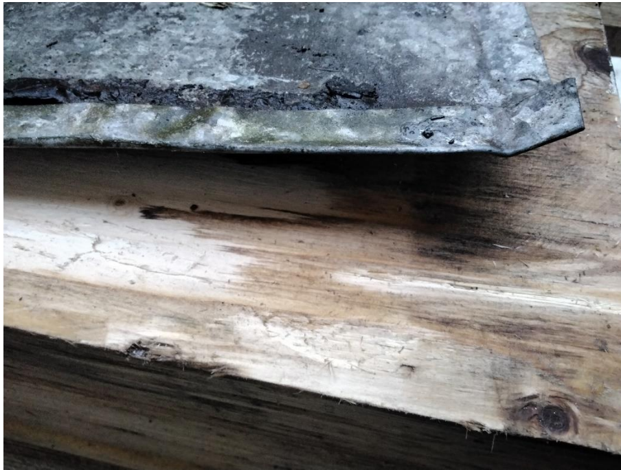
Рисунок 5.6 – Следы замачивания верхнего слоя шпона
