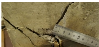
Рисунок 15 – Раскрытие трещин в местах наибольших разрушений
