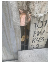
Рисунок 7 – Отклонение положения монтажной петли от проектного положения в процессе установки панели
