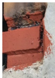
Рисунок 5 – Нарушение изоляционного окрасочного слоя
