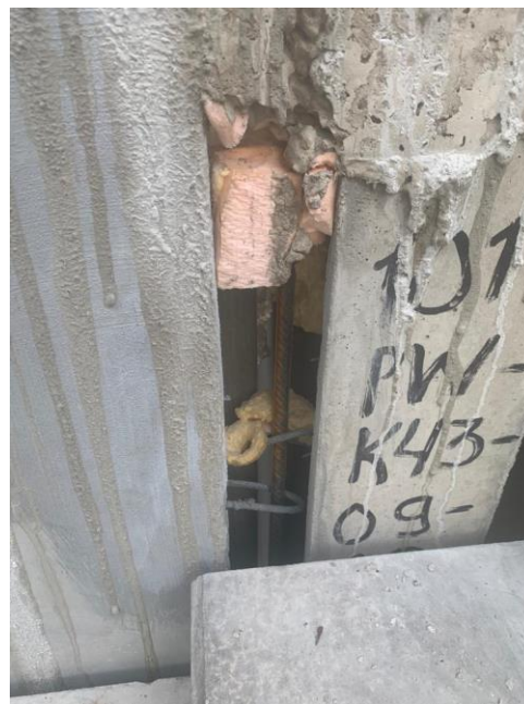
Рисунок 1.18 – Отклонение положения монтажной петли от проектного положения на строительной площадке.
