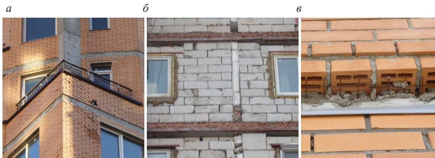
Рисунок 2 – Деструкция и повреждения кирпичной кладки в зданиях монолитной конструкции:
