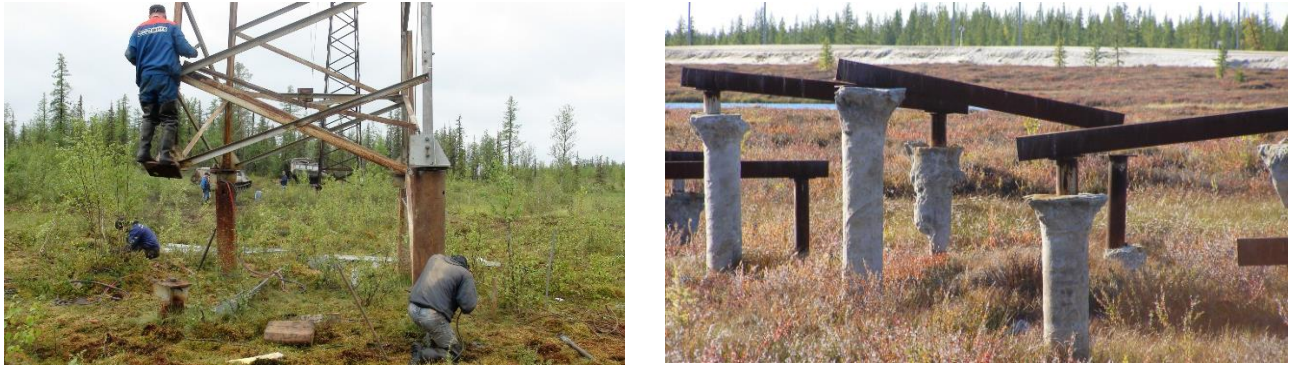
Рис. 1.1. Сооружения, фундаменты которых потеряли устойчивость при действии касательных сил морозного пучения
