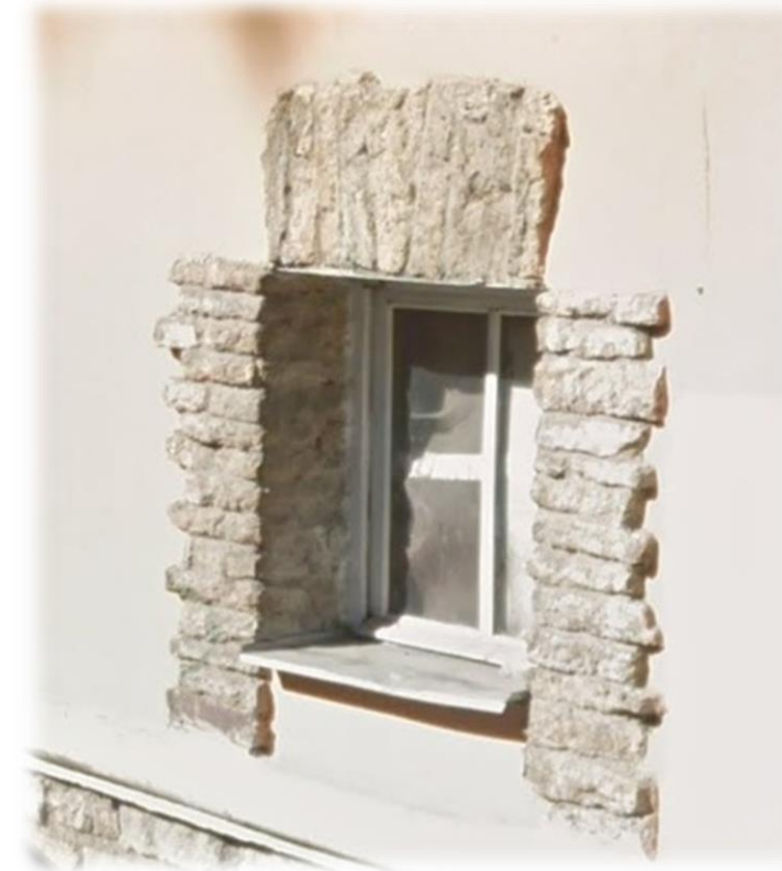
Тип 11. Образец оформления окна в каменной кладке (песчаник) и раскладкой на клинья
