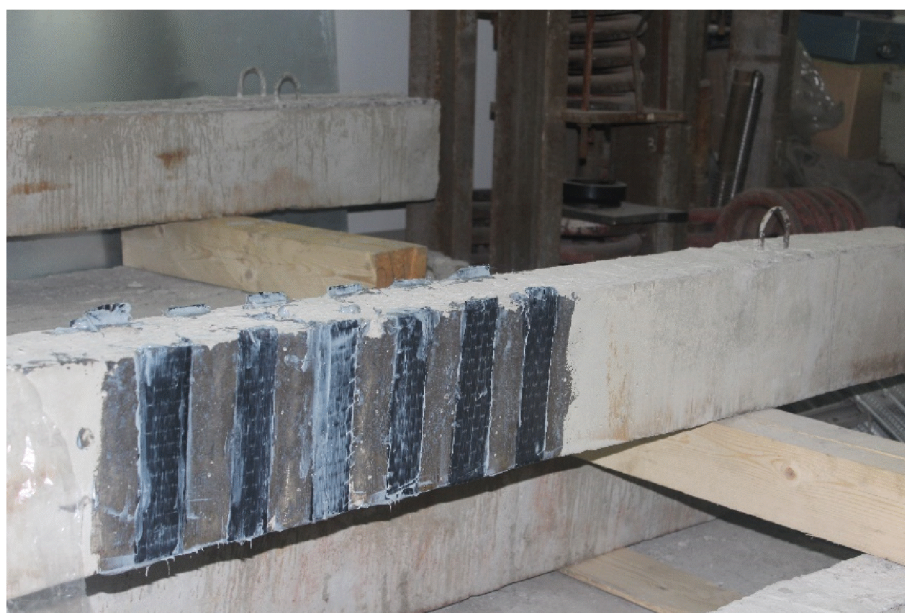
рис.3.2.1.4. Общий вид установленных хомутов
