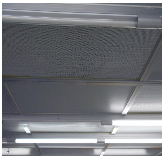
Рисунок 5.3 – Потолок чистого помещения, с установленными высокоэффективными воздушными фильтрами
