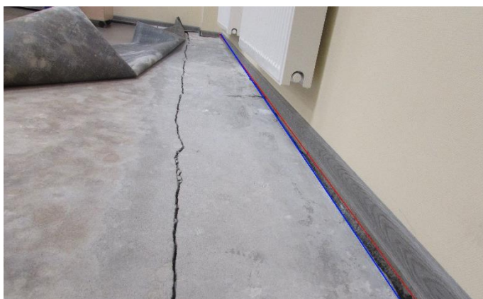
Рисунок 1.13 – Отрыв перегородок, трещины в конструкции пола (по материалам ООО «ИСП «Геореконструкция»)
