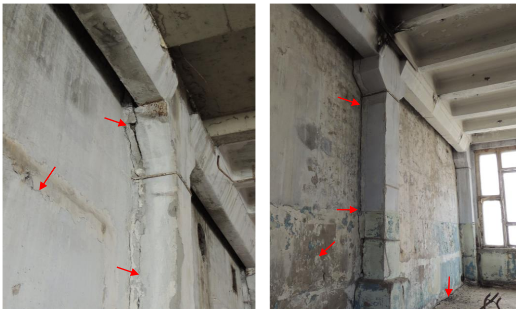
Рисунок 1.1 – Пример проявления трещин в конструкциях каркасного здания, расположенного в Василеостровском районе Санкт-Петербурга
