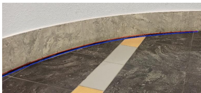
Рисунок 1.6 – Отрыв перегородки от перекрытия
