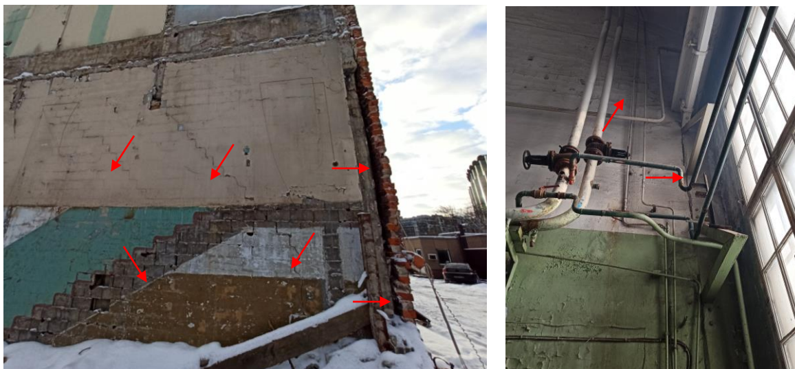
Рисунок 1.2 – Пример трещин и повреждений ограждающих конструкций каркасного здания, расположенного в Выборгском районе Санкт-Петербурга
