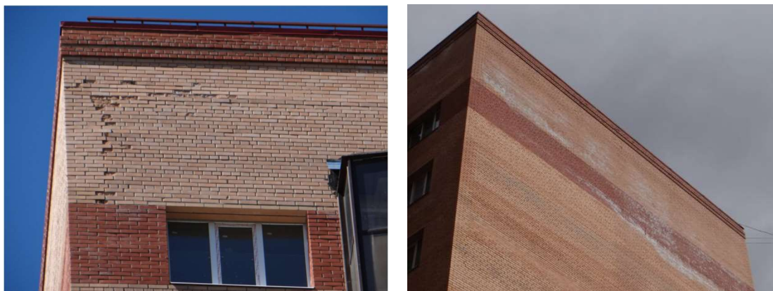
Рисунок 2.2 - Деструкция наружных стен (лицевой кирпич + газобетон)
