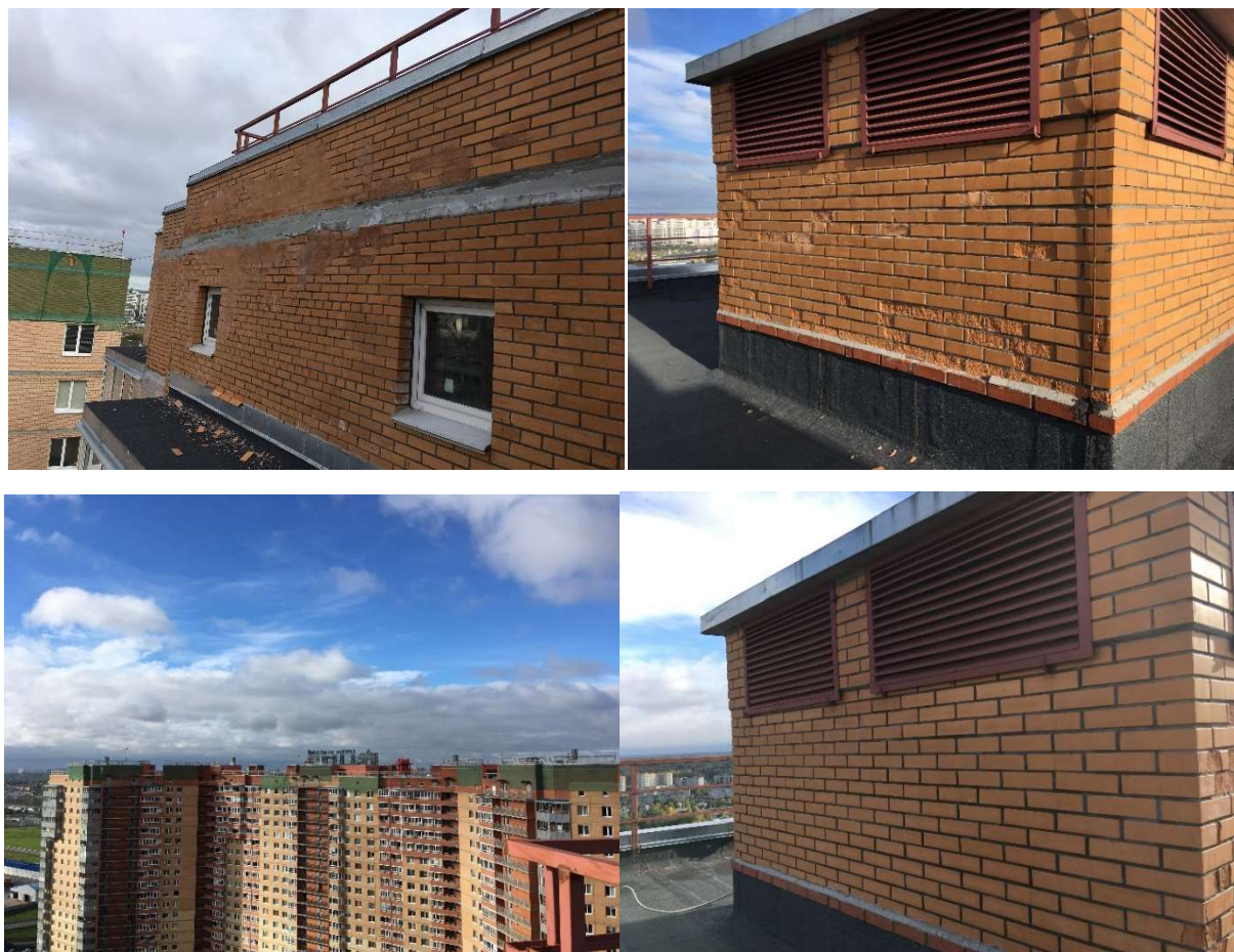
Рисунок 2.7 - Деструкция наружных стен теплых чердаков и поверхность вентиляционных шахт
