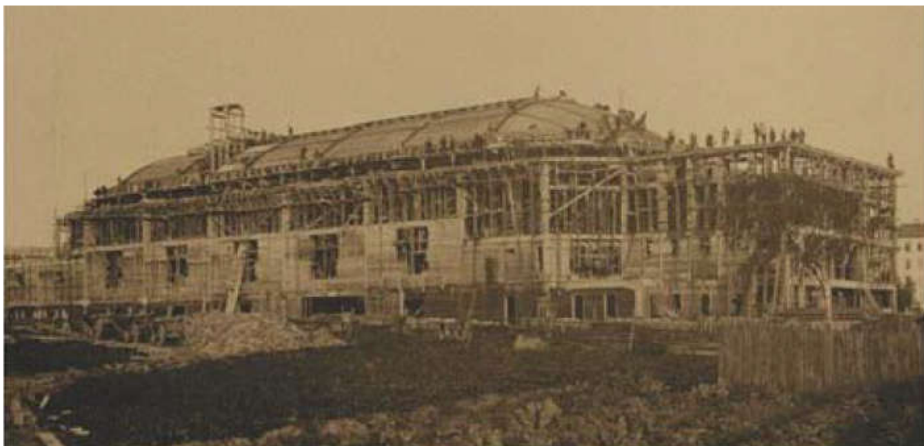
Рисунок Б.2.26. Спортинг-палас в процессе строительства. Фото приблизительно 1910 г. ЦГАЛИ, Ф. 100, О. 1, Д. 55
