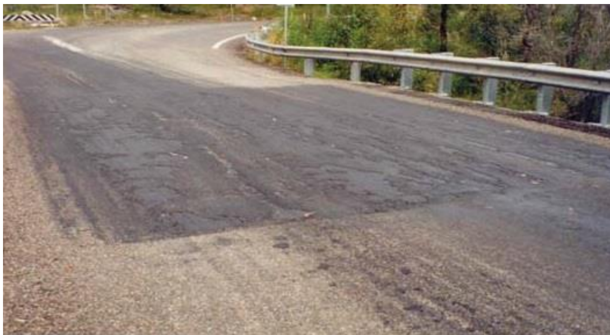
Рисунок 1.24. Деформации асфальтобетонного покрытия проезжей части, вызванные расслоением гвоздевой деревоплиты.
