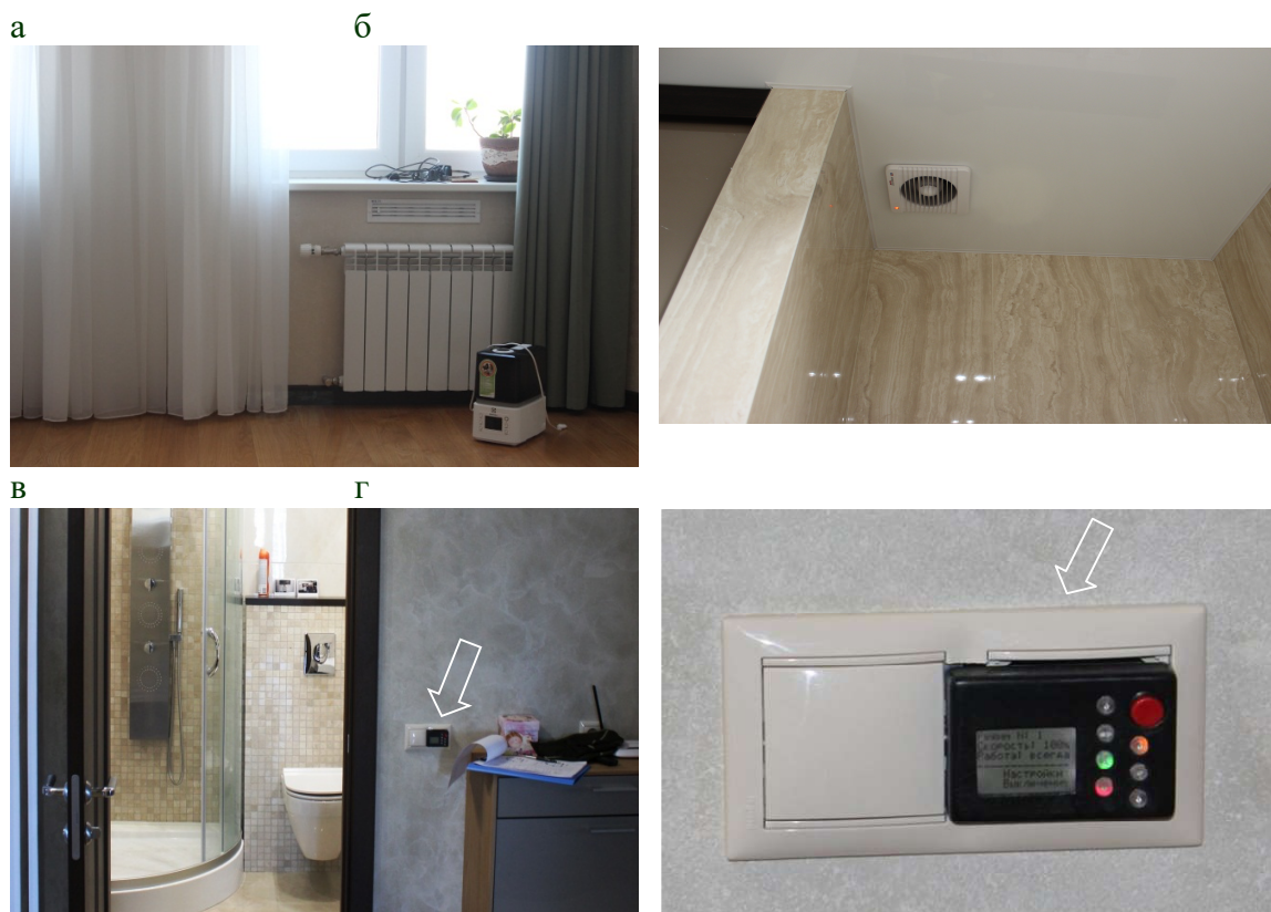
Рисунок 13 – Внешний вид некоторых элементов систем вентиляции жилых многоквартирных зданий с индивидуальными вытяжными вентиляторами: а – приточный клапан; б – вытяжной вентилятор; в, г – программируемый блок управления
