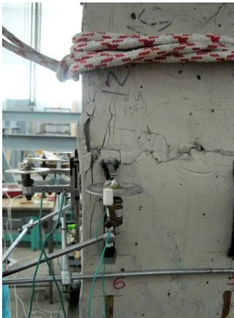
Рисунок 3.8 – Вертикальные трещины в приопорной зоне
