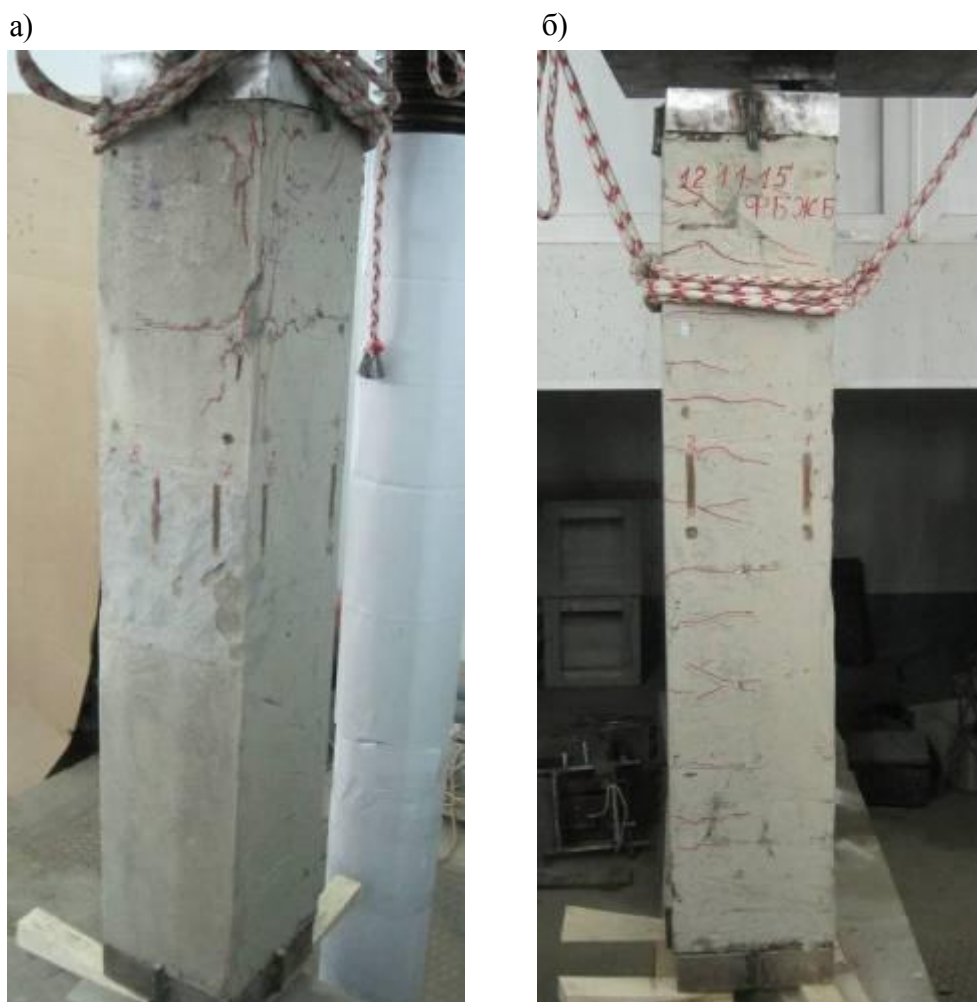
Рисунок 3.11 – Вид разрушенной фиброжелезобетонной стойки, e_x = 3 см, e_y = 6 см а) сжатая зона; б) растянутая зона
