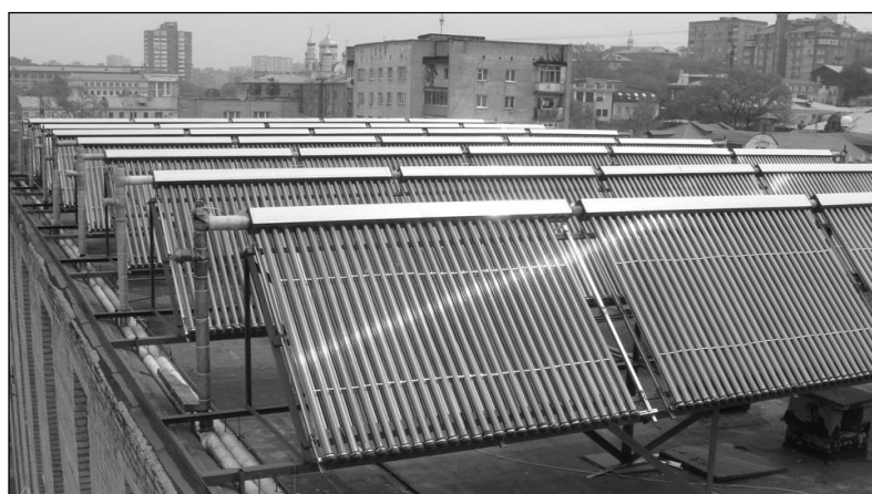
Рисунок 2.11 – Размещение и обвязка солнечных коллекторов СВНУ на крыше здания ДВФУ
