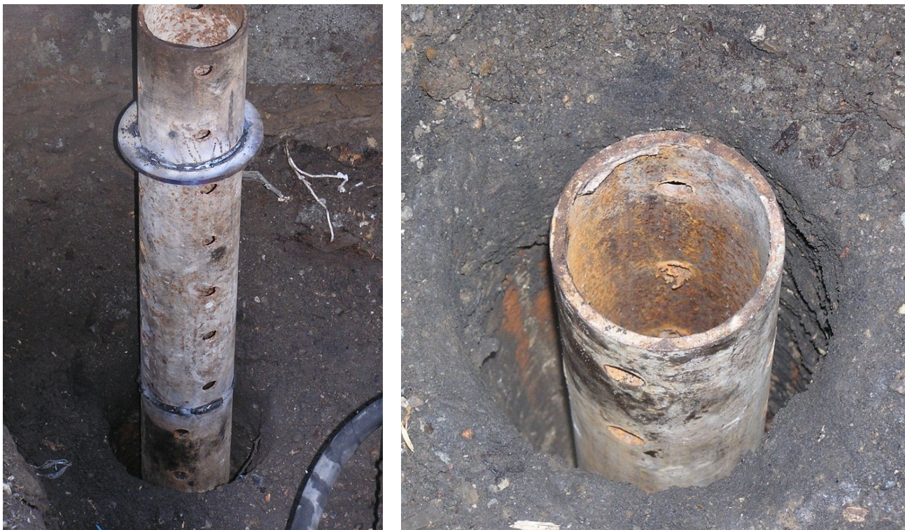
Рисунок 2.18 – Формирование воздушного зазора между инъекторной трубой и стенкой скважины при проведении испытаний на экспериментальной площадке
