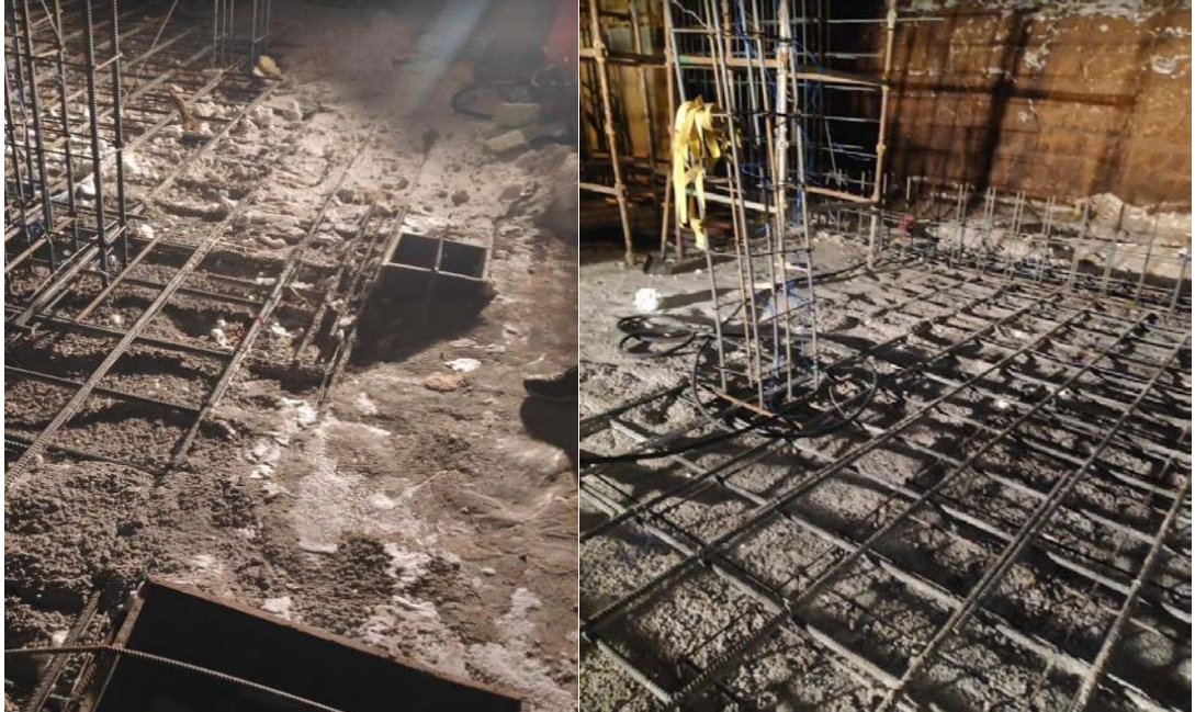
Рисунок 23 – Наклонный шов бетонирования в железобетонной фундаментной плите, г. Челябинск
