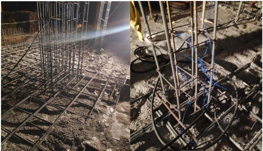
Рисунок 24 – Наклонный шов бетонирования в железобетонной фундаментной плите, г. Челябинск
