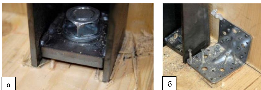
Рисунок 2.10 – Узлы крепления стеновых панелей и плит перекрытий из ДПК: а – ослабление болтов вследствие смятия древесины под ребрами П-образного стального профиля, б- выдергивание гвоздей из плит перекрытия в стальных уголках [204]
