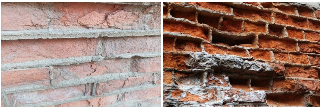
Рисунок 2 Разрушение керамического кирпича под влиянием эффекта обоймы.
