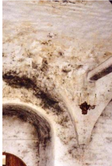
Рисунок 4 – Разрушение штукатурного цементного раствора в результате биодеструкции
