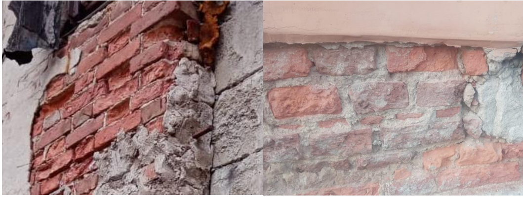
Рисунок 1 – отслоение штукатурного состава на основе портландцемента с разрушением лицевой поверхности керамического кирпича
