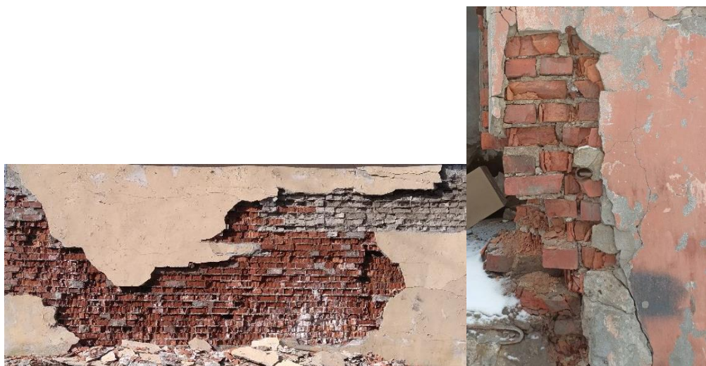
Рисунок 3 – Пример разрушения отделочного состава по причине водонасыщения при низком значении паропроницаемости
