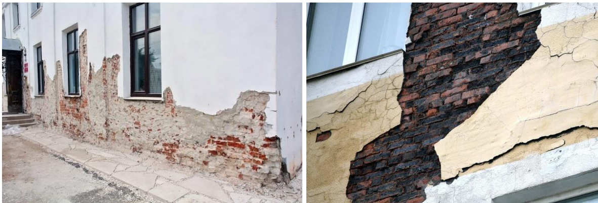
Рисунок 5 – Разрушение отделочного состава в областях накопления влаги по причине неправильной организации защиты фасада от атмосферных воздействий
