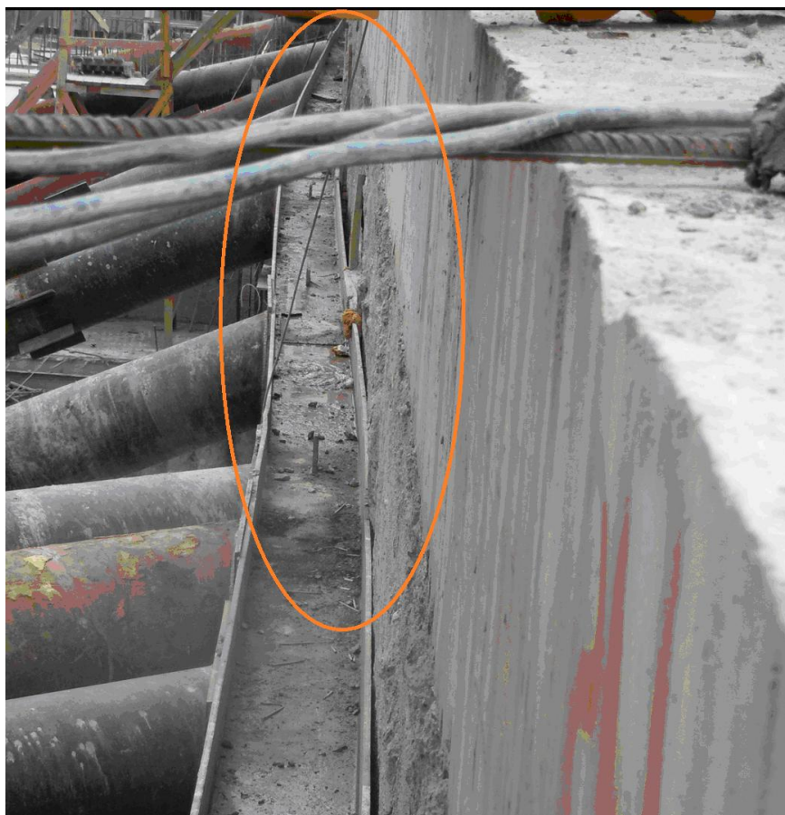
Рисунок 4.30. Отсутствие ребер жесткости на обвязочной балке и её деформация.
