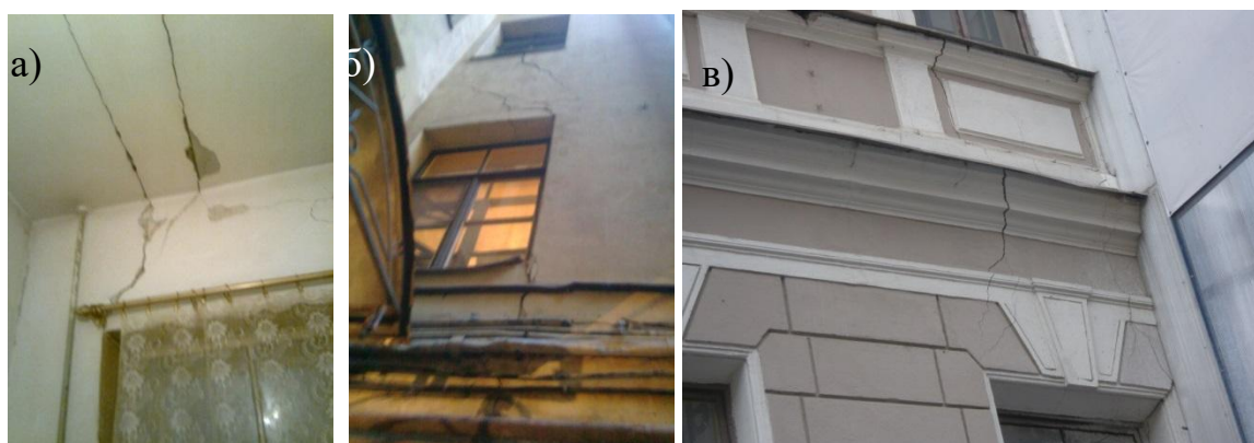
Рис. 8.18. Вид трещин внутри здания (а), по стене дворового фасада (б), на фасаде со стороны Кирпичного пер. (в)
