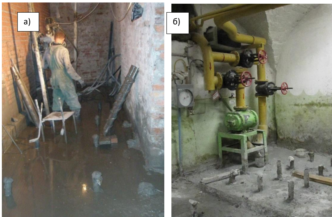
Рис.8.20. Производства работ по устройству лидерных скважин для установки манжетных колонн (а) и вид выпусков манжетных колонн при нагнетании закрепляющего раствора
