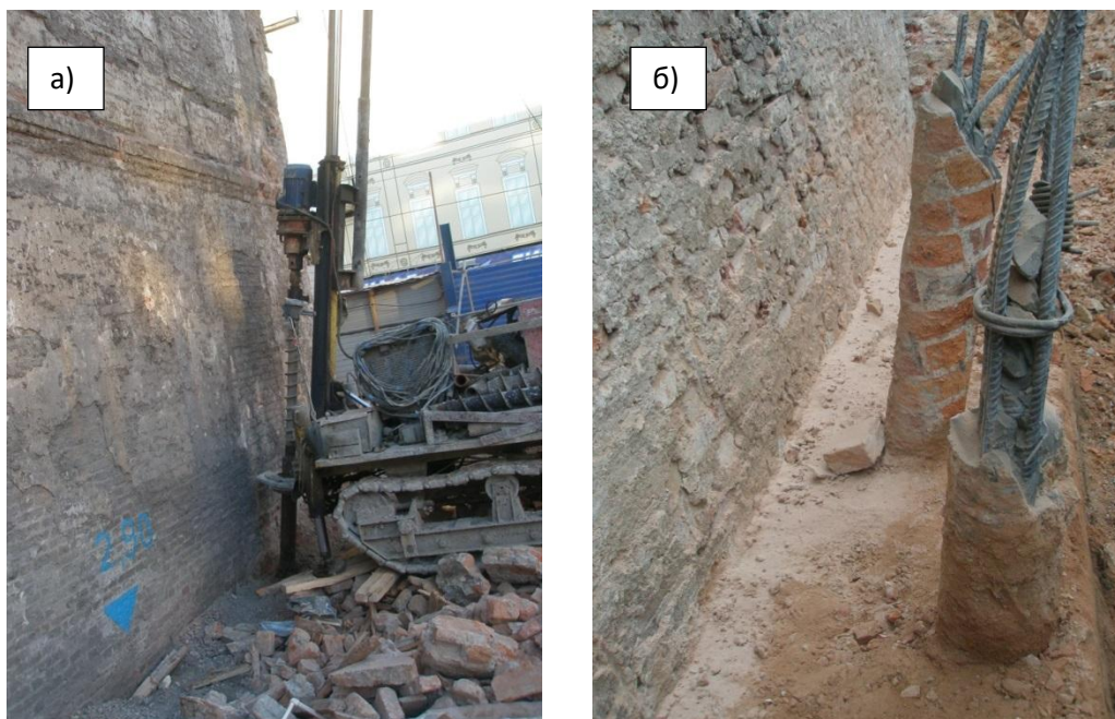
Рис. 8.17. Устройство скважины под кондуктор в теле старого фундамента при устройстве буроинъекционных свай усиления (а) и вид откопанных оголовкой выполненных буроинъекционных свай (б)
