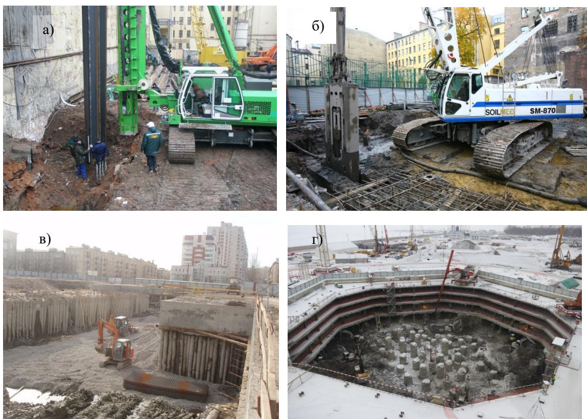
Рис.1.8. Производственный процесс вдавливания шпунта AZ установкой Vanut 655 при строительстве II очереди гостиницы «Невский Палас» на Невском пр. 55 (2007) (а); устройство конструкции «стена в грунте» установкой SoilMec SM 870 на строительстве гостиницы на ул. Правды, д.10 (б)(2009); конструкция ограждения котлована при строительстве паркинга жилого комплекса на ул. Благодатной из касательных свай (в), вид ограждения котлована «стена в грунте» толщиной 1200 мм и распорных дисков перекрытий при устройстве фундаментов ОДЦ «Лахта-центр» (2014) (г) [152, 178, 180].
