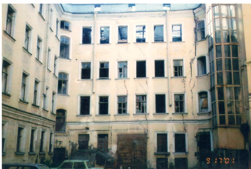
Рис. 3.35. Общий вид аварийных повреждений в соседнем с гостиницей здании – д.55 по Невскому пр.
