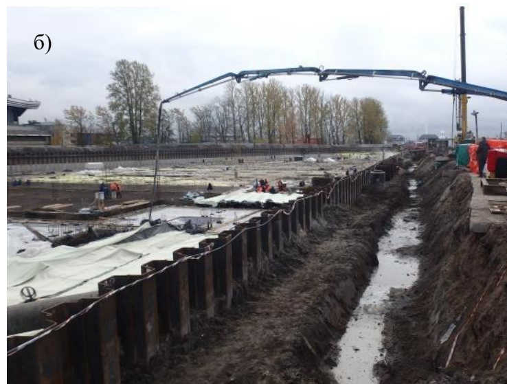
Рис. 3.3. Использование для раскрепления котлована грунтовых берм (а) с последующим устройством подкосов; применение для обеспечения устойчивости ограждения котлована разгрузочной траншеи со стороны бровки котлована (б)
