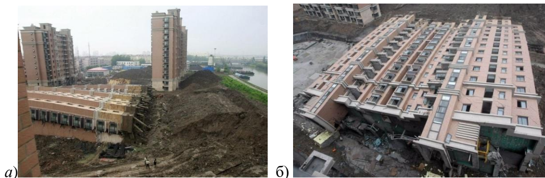
Рис. 2.29 . Дом, рухнувшего в котлован – видны трубчатые забивные сваи, которые разрушены при падении (а) и видны конструкции плиты в котловане (б).
