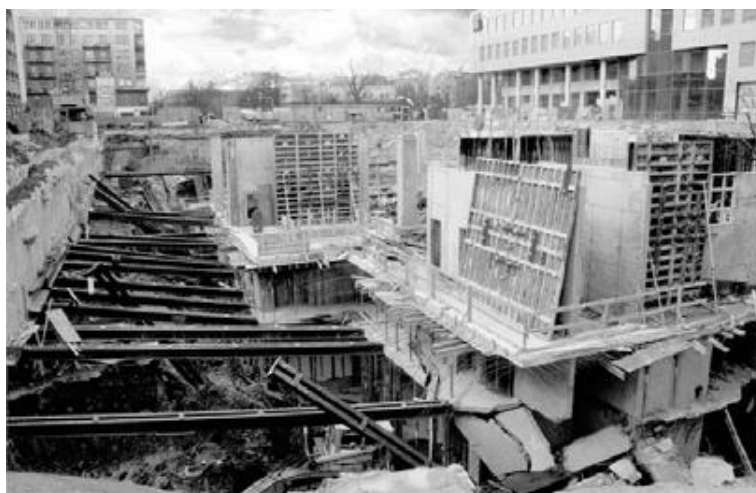
Рис.2.25. Вид с угла обрушившейся стены котлована в Варшаве (Brandl, 2007)
