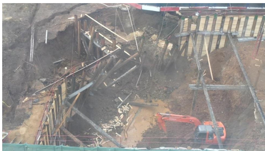
Рис.2.16. Вид разрушений шпунтовых стен котлована на площадке строительства административного здания на ул. Профсоюзов, вблизи д. 91 в Москве
