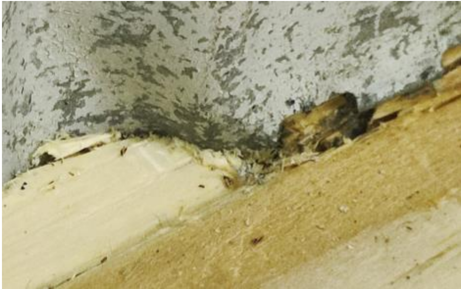
Рисунок 3.32 – Повреждения по материалу поясов (LVL) испытываемых балок – смятие древесины при контакте с зубом.
