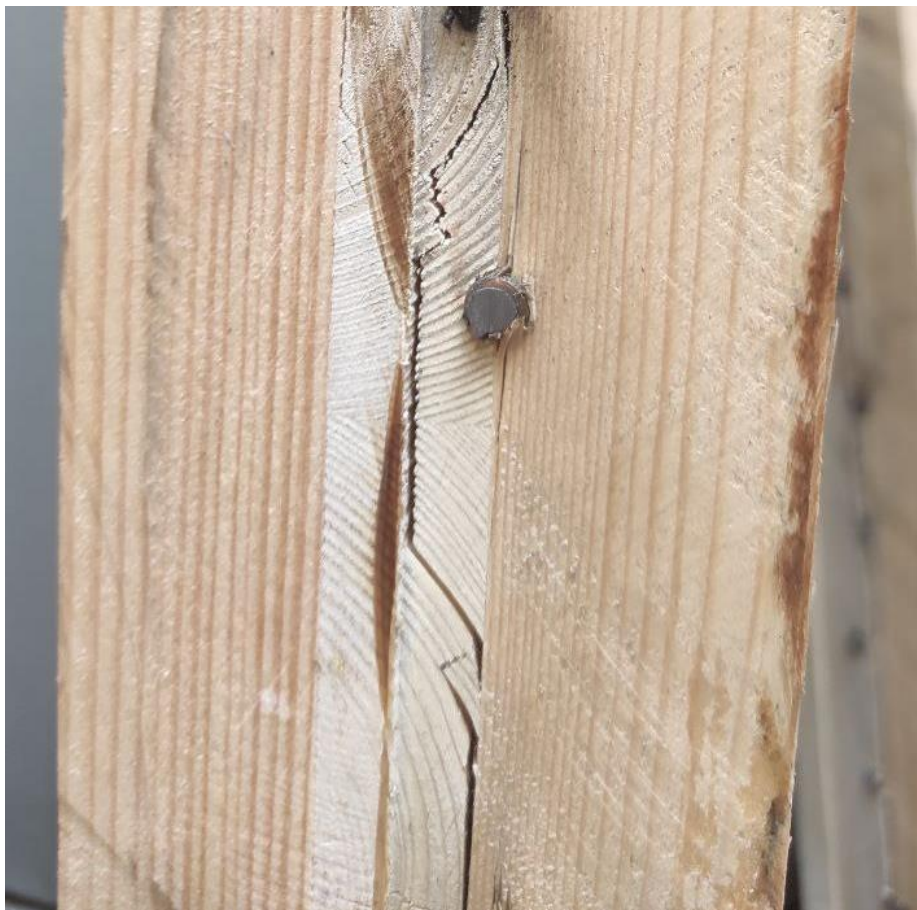
Рисунок 4.16. Разрушение среднего слоя оболочки
