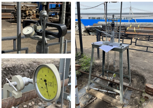
Рис. 8. Полевые испытания свай статической выдёргивающей нагрузкой: а) результаты испытаний; б) процесс испытаний
