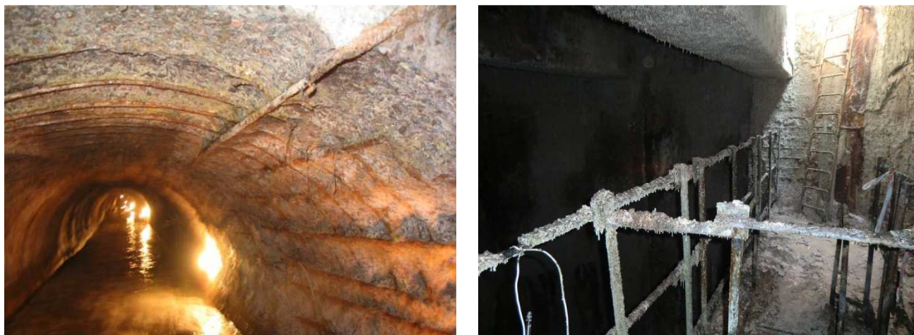
Рисунок 1.3 – Фото слева. Оголение арматурной сетки вследствие бетонной коррозии сооружений КС. Фото справа. Классическая ситуация в шахте на КС
