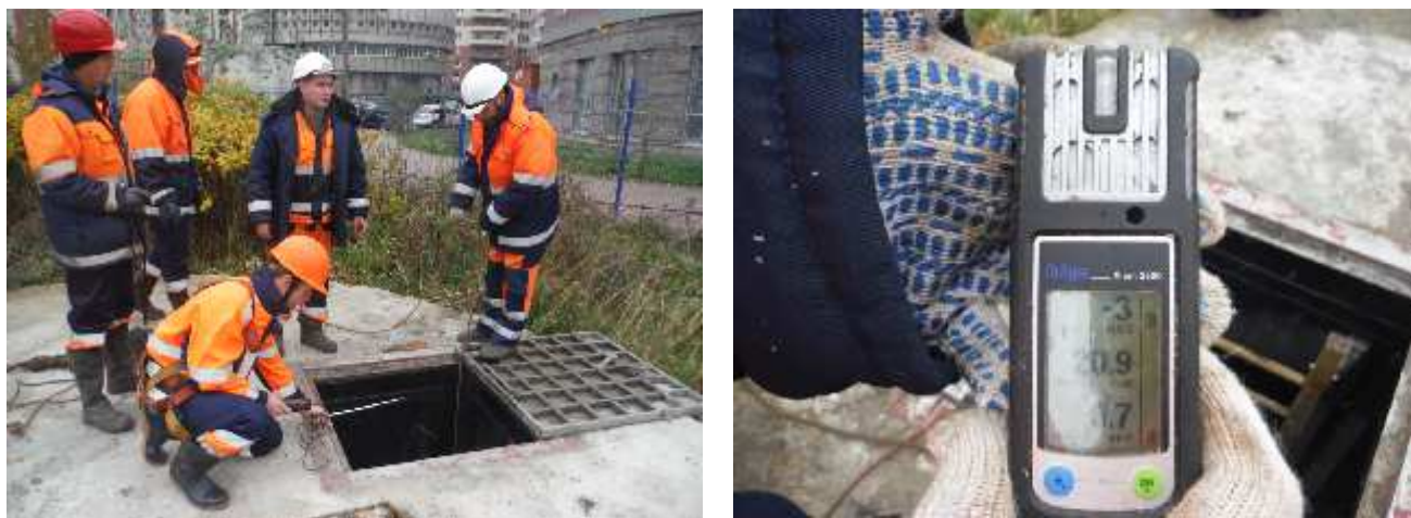
Рисунок 3.15 – Замер скорости и направления движения газа через людской лаз шахты при вентиляции шахты естественным путем
