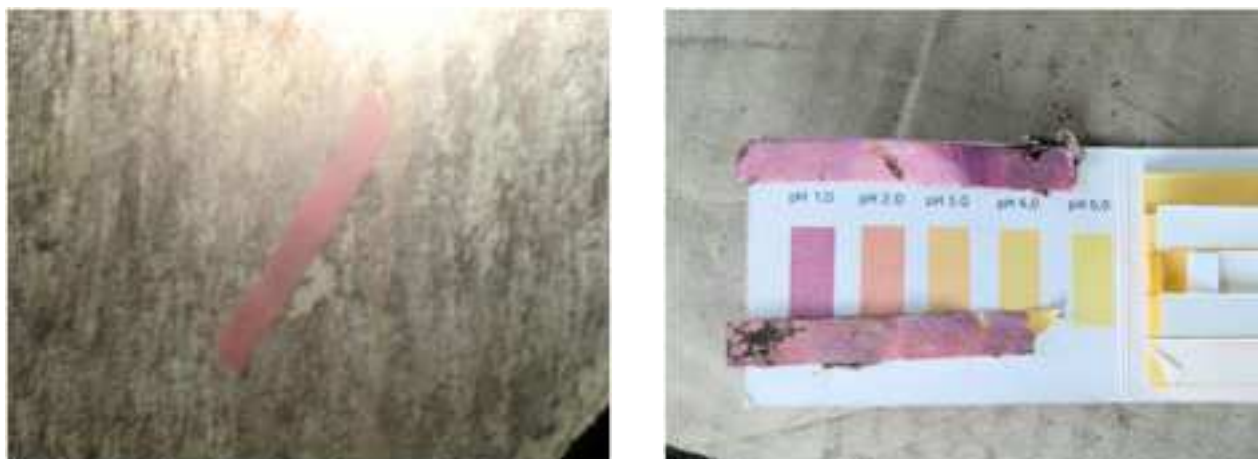
Рисунок 1.7 – Измерение pH на бетонной поверхности и лестничном марше, выполненном из композитного материала, в шахте № 10 на ул. Верности (май 2011 г.) КС. В обоих случаях pH=1
