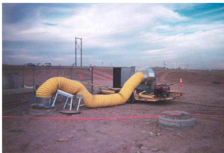
Рисунок 1.28 – Вентиляционная установка экспериментального назначения в г. Феникс, штат Аризона. Производится эмпирический подбор мощности оборудования
