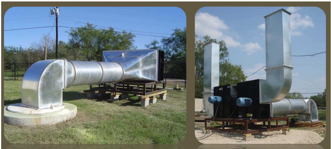
Рисунок 1.26 – Организация газообмена в канализационном коллекторе г. Остин, штат Техас, США за счет депрессии, создаваемой вентиляторами. Справа — экспериментальная установка, слева — стационарная (рабочая) установка
