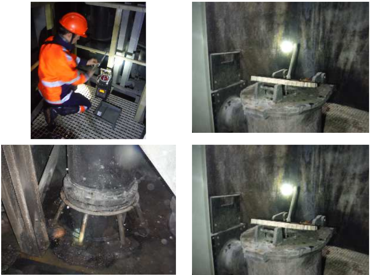
Рисунок 3.12 – Состояние шахты 350Б в октябре 2016 г.
