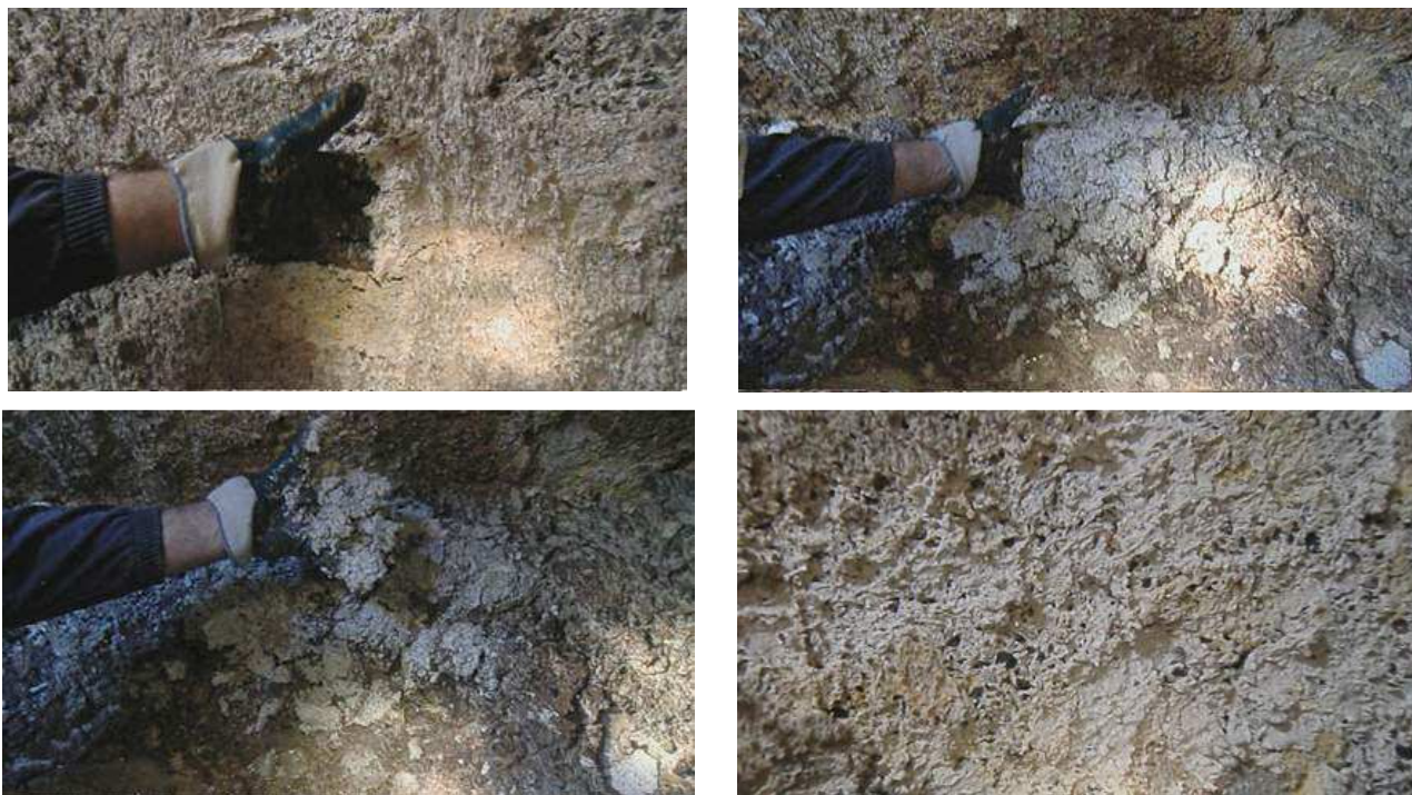
Рисунок 1.2 – Визуальный контроль. Коррозионные потери бетонных поверхностей канализационных коллекторов на шахте № 10 в Санкт-Петербурге, ул. Верности (май 2011 г.)
