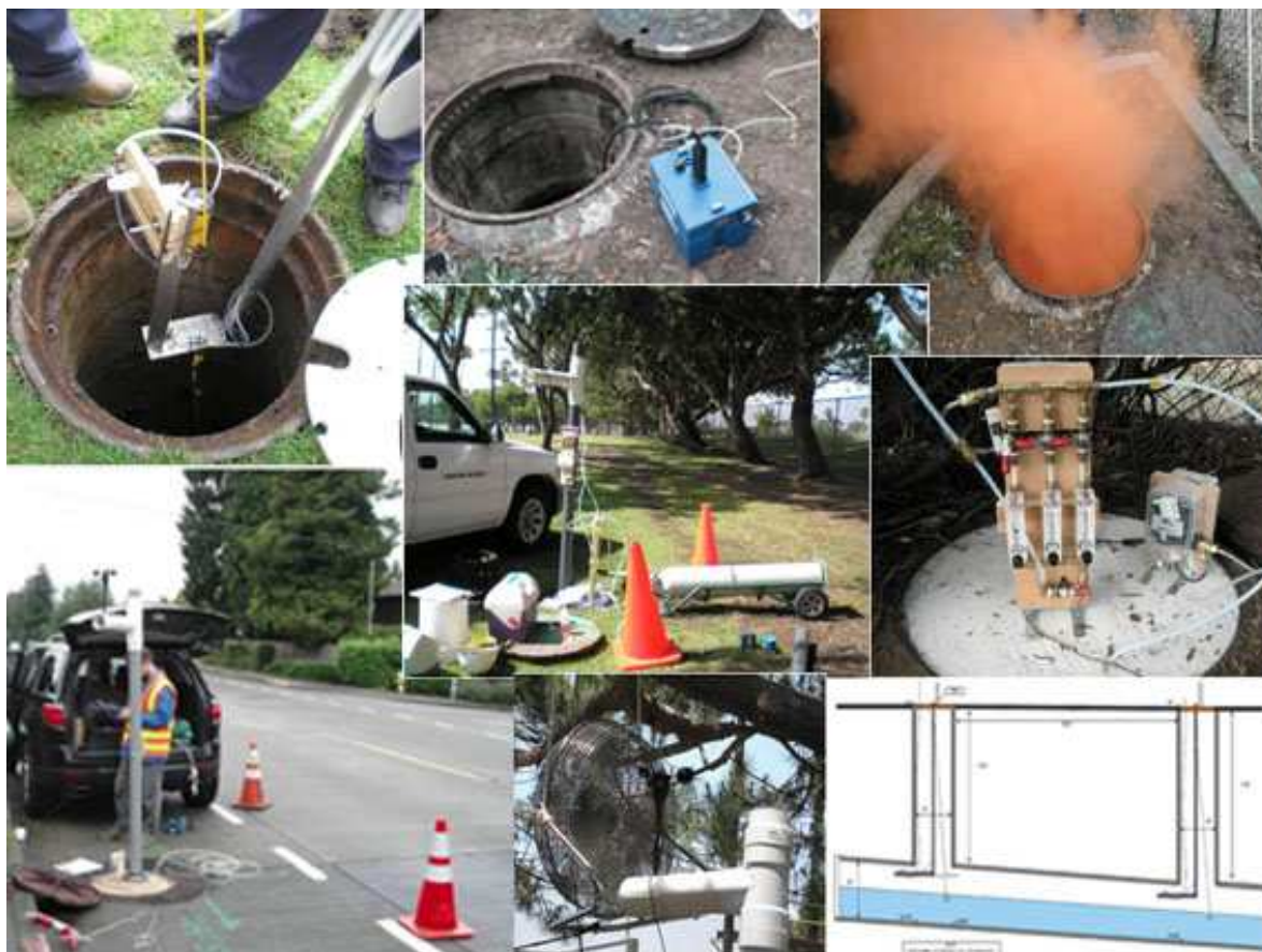
Рисунок 1.27 – Фотоматериалы производства работ по замеру параметров КС округа Лос-Анжелес, США для последующего подбора вентиляционного оборудования
