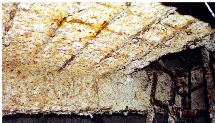
Рисунок 3.11 – Разрушение потолочной части перекрытия площадки шахты 350Б 2002г.
