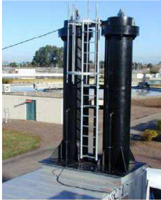
Рисунок 1.21 - Общий вид полупромышленной установки на очистных сооружениях г. Ере
