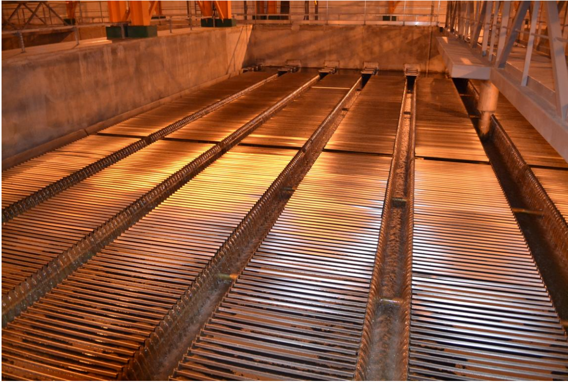
Рис. 4.2. Полочный отстойник блока К-6 ЮВС г. Санкт-Петербурга
