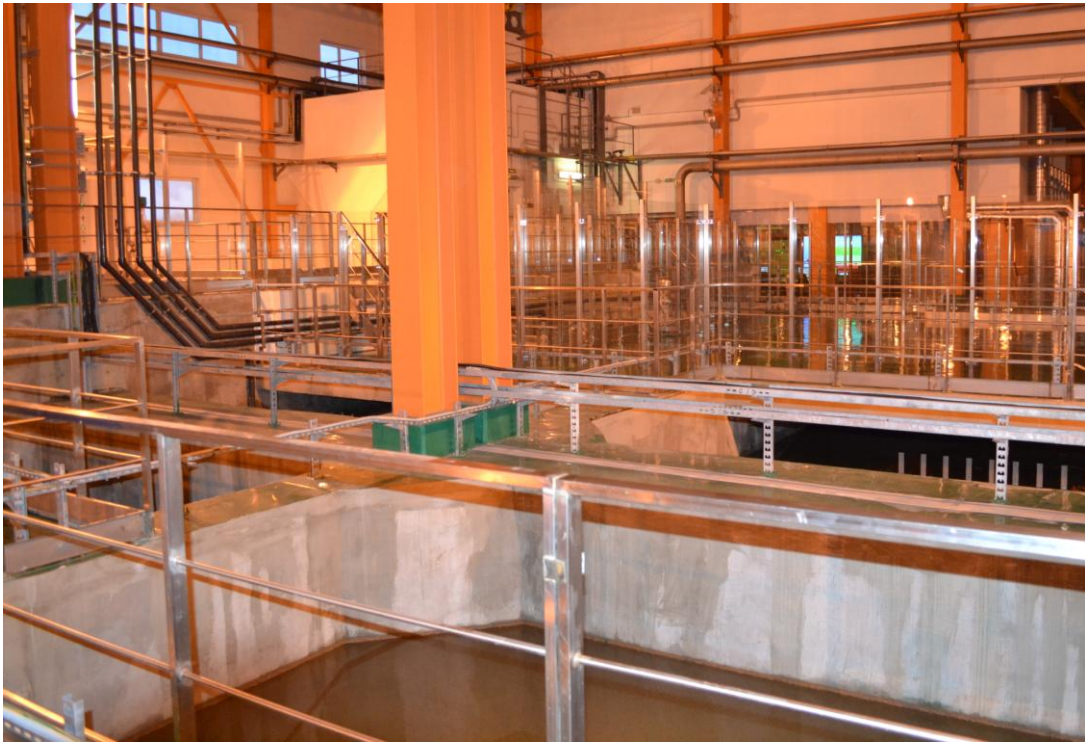
Рис. 4.12. Комплекс очистных сооружений блок К-6 ЮВС
